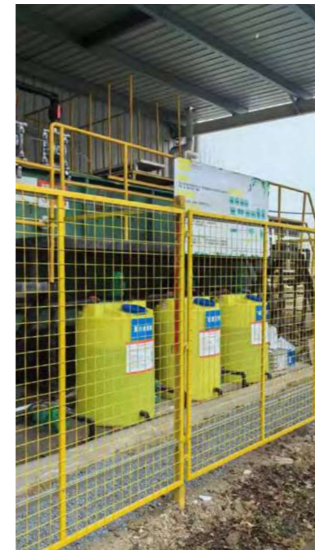
▲ 合肥家电污水站
